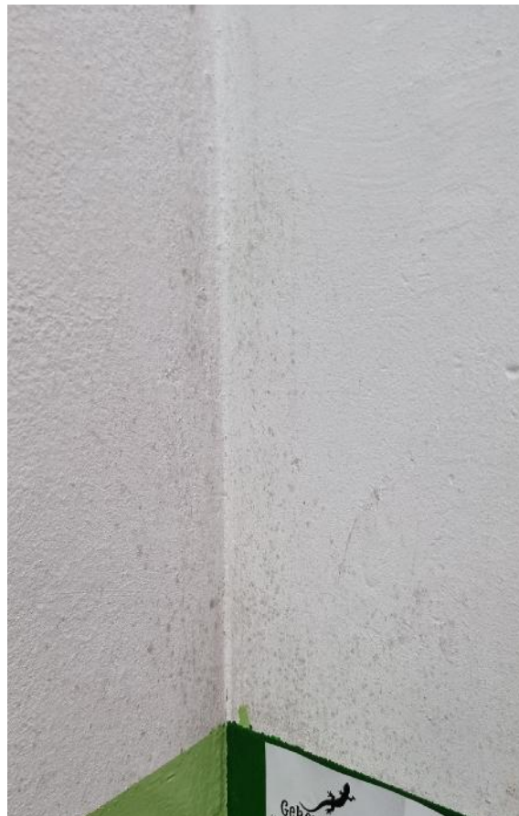
Fot. 8 Widok pleśni na ścianach szatni
